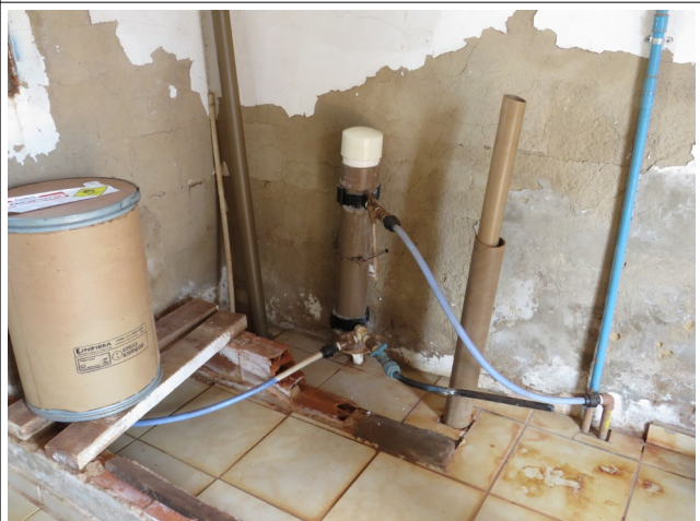
Autor: AMAE/RIO VERDE Descrição: Sistema de cloração por pastilhas utilizado
