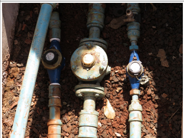
Autor: AMAE/RIO VERDE Descrição: Macromedidores de entrada no reservatório.
